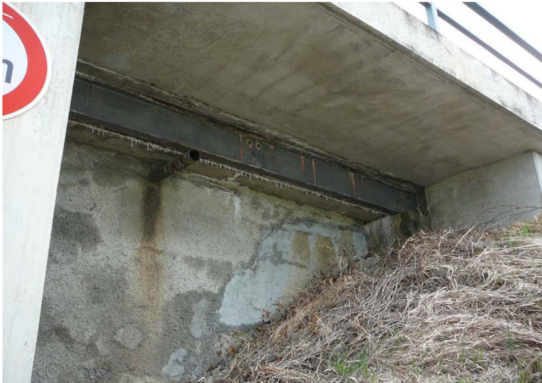
Standpunkt am Böschungsfuß l.d.B. am Widerlager 1 (Ost) unter dem Gegengleis Blick auf die verputzte Flügelebene mit Feuchtedurchtritt und Aussinterungen zwischen Bestandsbauwerk und der Verbreiterung aus dem Jahre 1997
