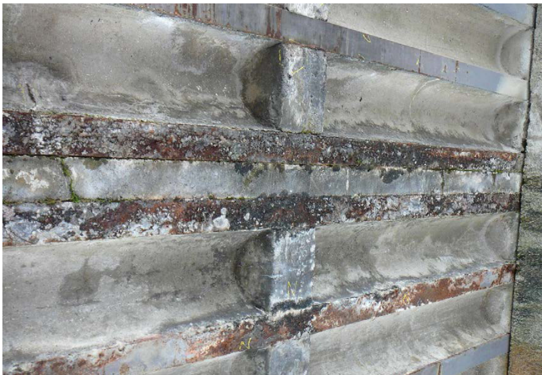
Standpunkt auf der Jesenwanger Straße am Widerlager 99 (West) unter der Streckenachse Blick auf die Untersicht Überbau: keine Bauwerksfuge der Fahrbahnplatte in Streckenachse, gerostete Längsträger mit Rostkerben bis 10 mm, massive Aussinterungen im Kassetten-beton: -> undichte Abdichtung, Feuchtedurchtritt in der Lagerfuge
